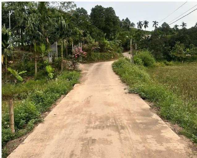
Hình 1.3. Hiện trạng đường BT 3m
