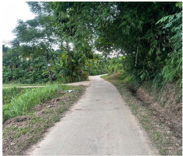
Hình 1.4. Hiện trạng đường BT 2,5m
